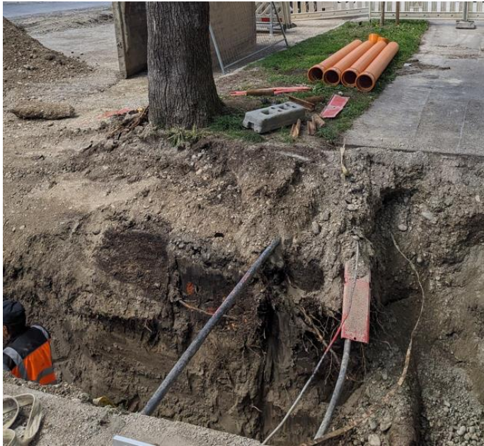
Freiliegende Wurzeln nach Saugbagger Einsatz. Kein Rückschnitt. Verfüllung.
