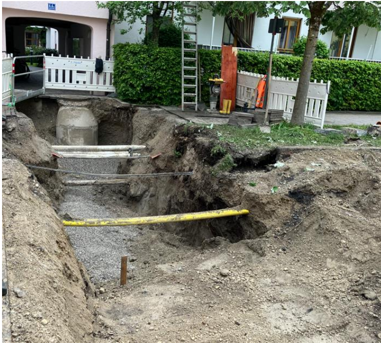
Beispielbilder Spartenlage im Bereich Bäume. Vorschädigung offensichtlich. Zusätzliche geringe Beeinträchtigung Wurzelraum durch Erdarbeit Hausanschlüsse. Platzbedarf nötig.
